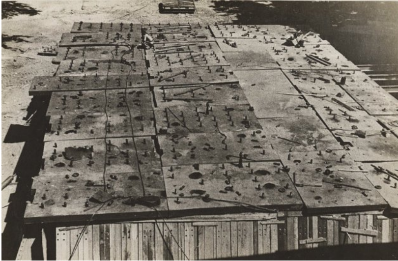
Ил. 10. Общий вид верхнего покрытия из бронеплит. Часть гаек и шайб снята с гужонов 1 перед стяжкой плит между собой от сдвигов. На заднем плане за КП — трейлер для перевозки бронеплит
