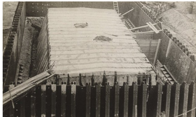
Ил. 4. На фото представлено сооружение после окончания работ по внутреннему контуру. Установлены семишпангоутные срубы внешнего контура. Дверной проём, ведущий к помещениям, в них ещё не прорезан. Забетонирован внутренний контур сооружения, сделана гидроизоляция крыши. В левом нижнем и правом верхнем углах видны ленточные транспортёры подачи материалов для засыпки внутреннего пространства песком. Интересно, что на крыше запечатлены два краснофлотца, отдыхающие после работы, рядом с одним из них лежит метла
