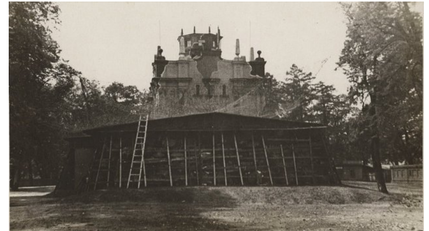
Ил. 11. В левой части снимка видны полосы, которыми во избежание сдвигов броневые плиты скреплялись друг с другом. Идёт работа по укладке мешков с хлопком. Установлена часть деревянного каркаса крыши. Все работы ведутся под маскировочной сетью
