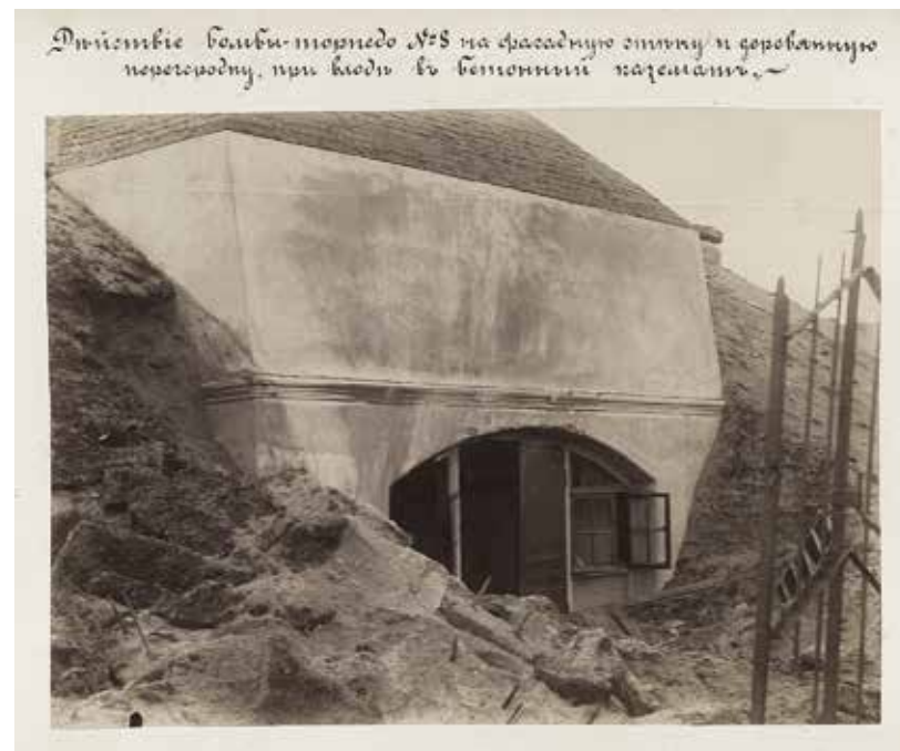
Ил. 8. Фото бетонного каземата «А» после обстрелов. Фото 1890 г. РГАВМФ. Ф. 1341. Оп. 3. Д. 588. Л. 3
